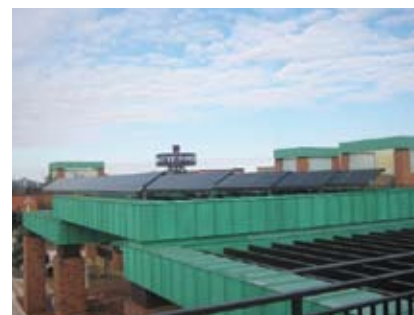
파주아울렛 태양광 발전 시설
